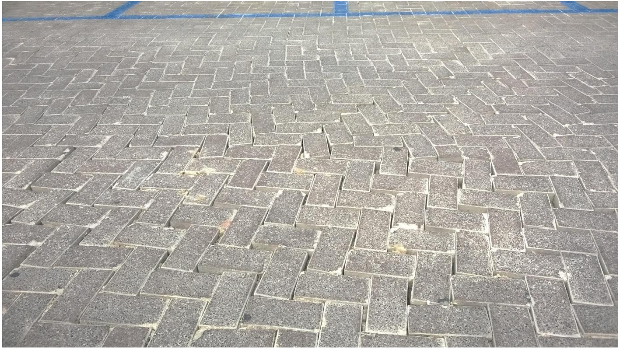
Figur 3-3 Exempel från bussgata utan inspänning. Förlust av fogmaterial har inte åtgärdats och fogförskjutning uppstår.
